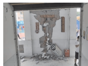
图5 福集镇龙脑桥中心小学框架结构填充墙破坏
