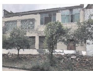
图8 玉蟾街道龙华村砖混结构房屋女儿墙倒塌
