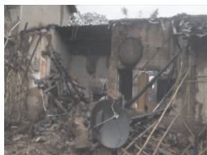
图2 福集镇草坝村土木结构房屋倒塌
