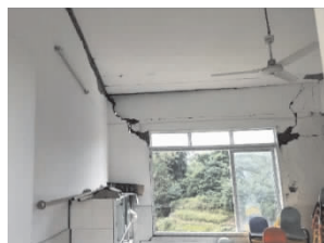
图4 福集镇中心小学幼儿园砖混结构窗洞口裂缝
