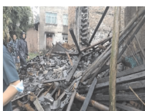
图7 喻寺镇齐心村砖木结构房屋倒塌
