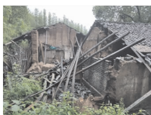
图6 童寺镇黄凤村土木结构房屋局部垮塌
